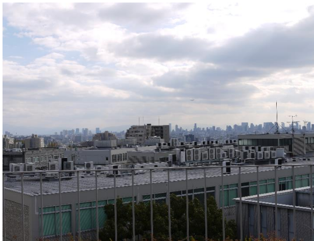
圖 82 空調設備主機皆置於頂樓並且有規劃的擺設(關大)
