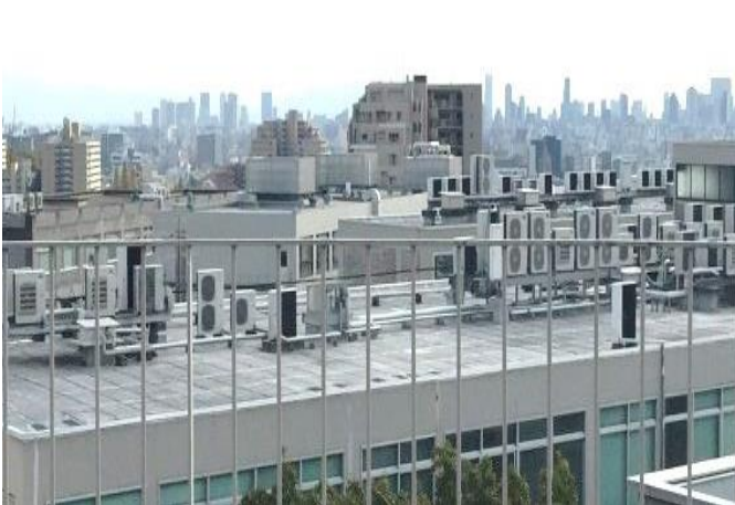
圖 93 關西大學頂樓空調主機
